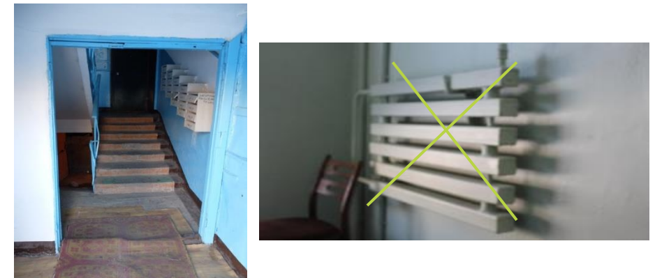
Отсутствие тамбура и холодные неотапливаемые подъезды
