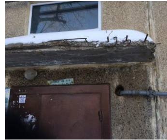
Разрушение козырька над входом
