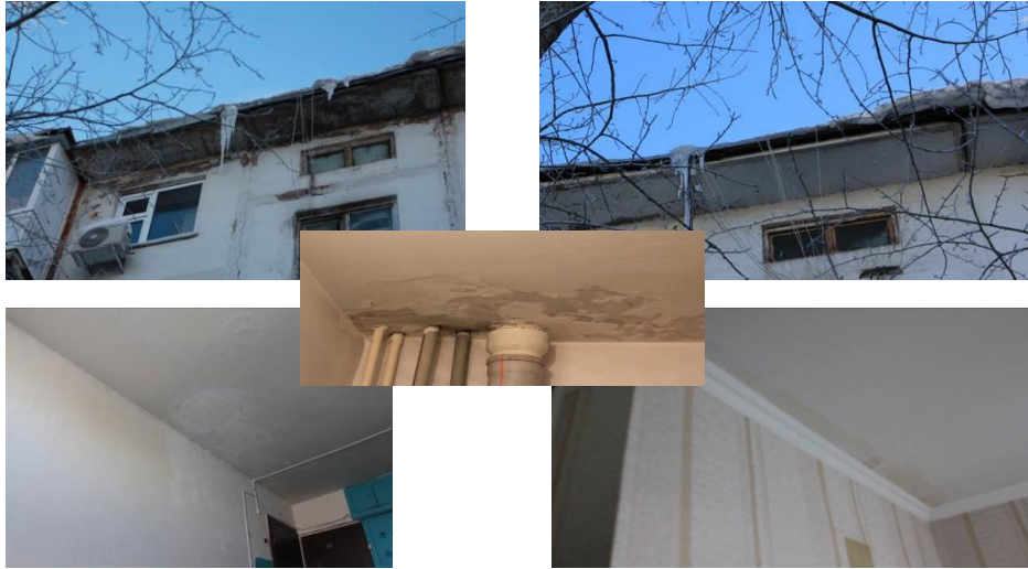
Отсутствие водостока, нарушение гидроизоляции кровли
